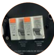
Disjoncteurs différentiels en entrée et sortie 230 V
